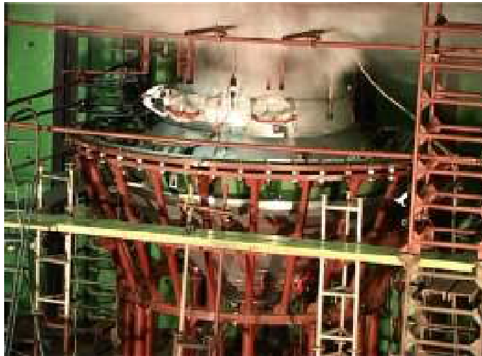
Рис. 7. Начало процесса разрушения ТО 3-й ступени
