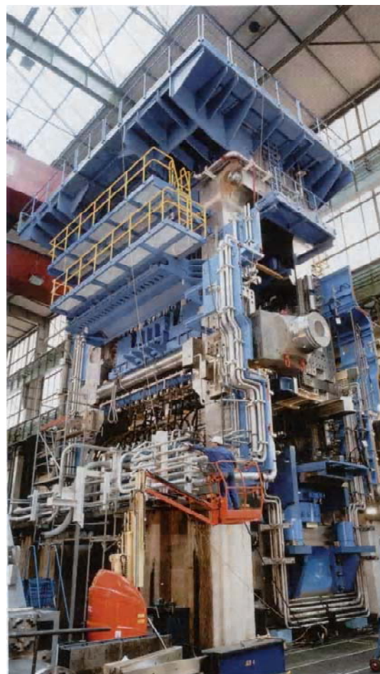
Рис. 5. Прокатная клеть 5000 на стенде
